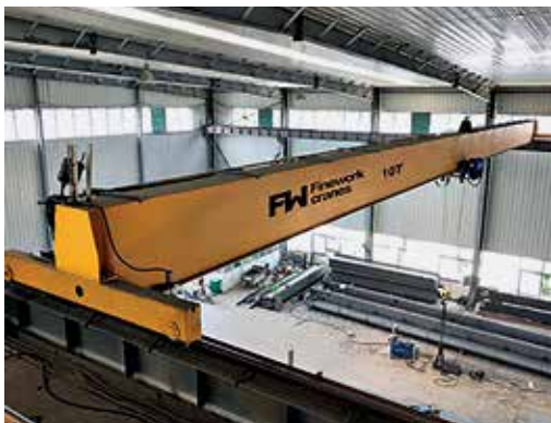
ΕΙΚΟΝΑ 1: Γερανογέφυρα μονής δοκού
